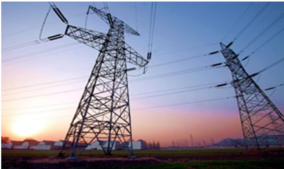
河南省某变电站改造项目
