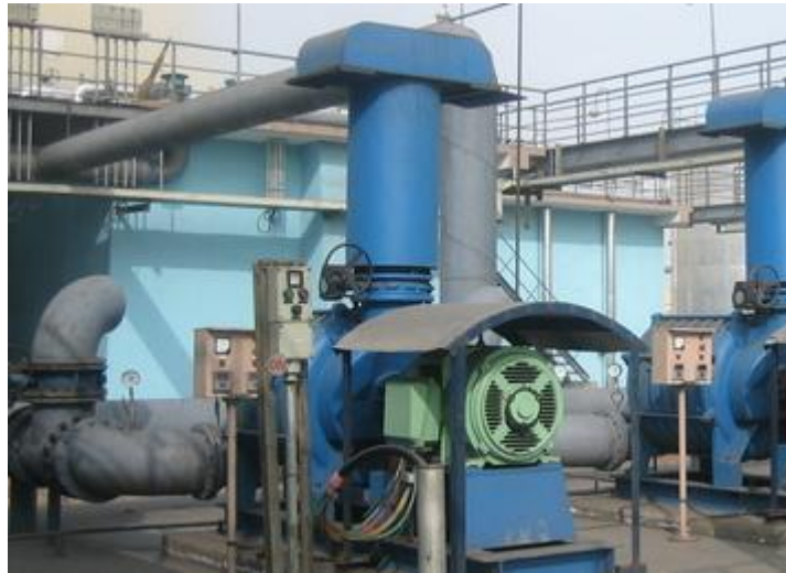
山西某煤矿主通风机项目
