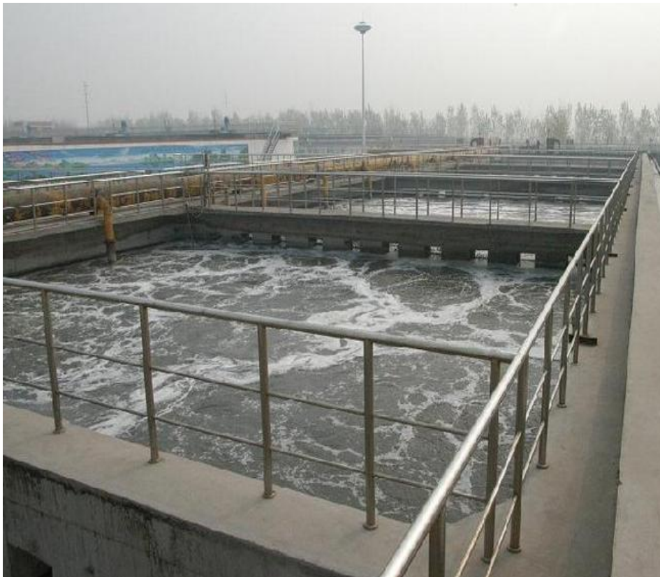
江西某污水处理厂项目
